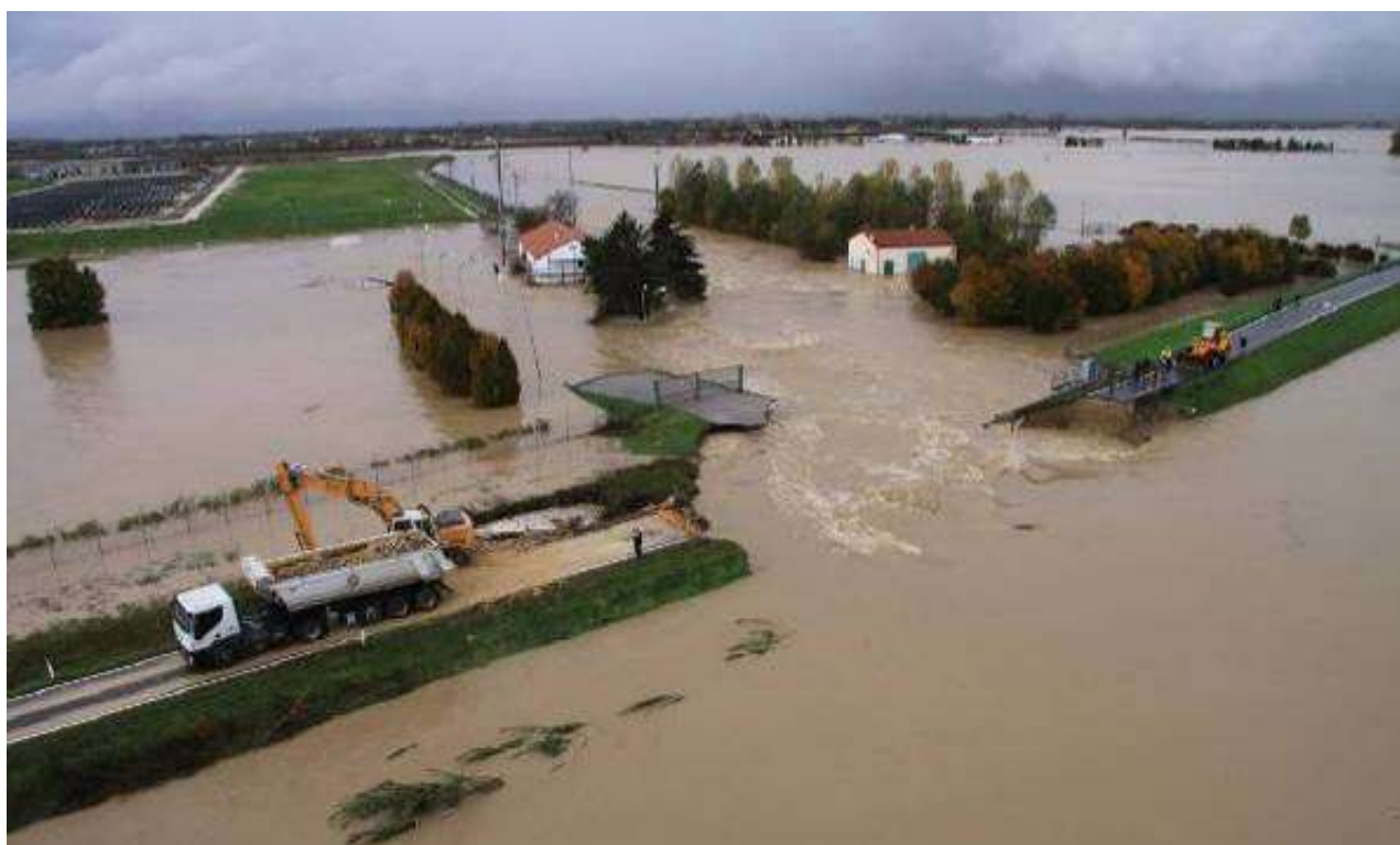
Figura 7 - La rotta del fiume Roncagette (Bacchiglione) a Ponte San Nicolò (PD) del 2 novembre 2010. Bacino del Brenta-Bacchiglione
